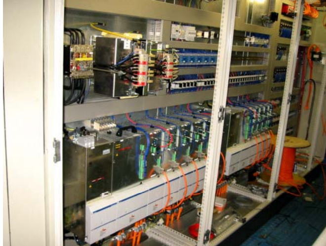
Bild 2: Schaltanlage mit Antriebstechnik
